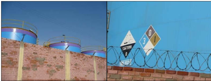
FIGURA I.10. ALMACENAMIENTO DE MATERIAL CORROSIVO EMPRESA QUIMPAC SA, PARAMONGA
