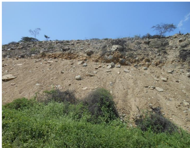
Ladera con ocurrencia de caída de rocas
