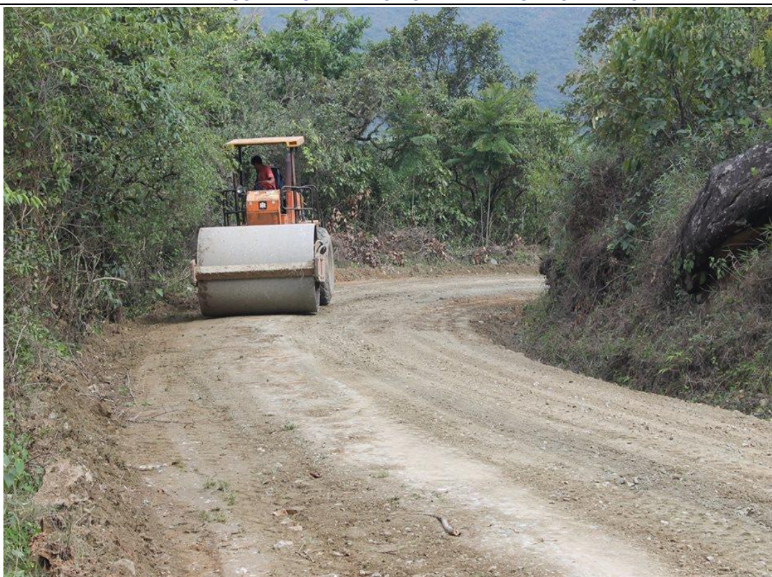
Figura 8. Carretera Lonya Grande – Camporredondo – Ocalli – Providencia -Ocúmal – Conila – Luya II Eje Vial
